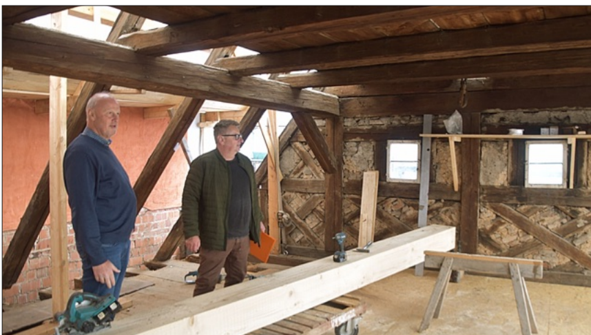
Bürgermeister Gerald Brehm und Architekt Georg Leyh beim Begutachten der Sanierungsarbeiten im Dachstuhl.
